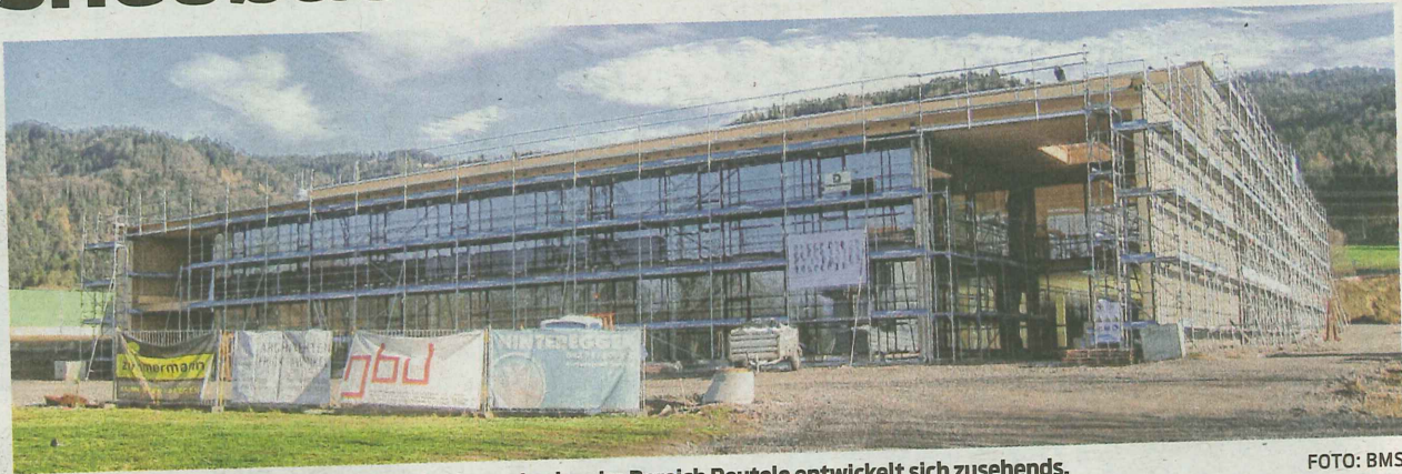
Der Typico-Betriebsneubau an der Peripherie von Lochau im Bereich Reutele entwickelt sich zusehends.
